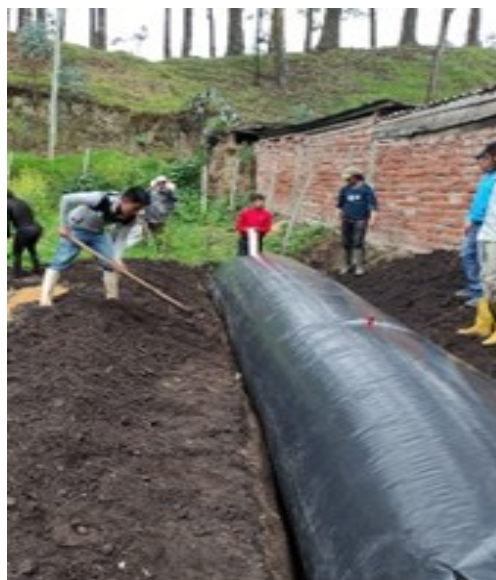
Figura 3. Instalación del biodigestor tubular en el sector conventillo, cantón Guaranda. Provincia Bolívar.
